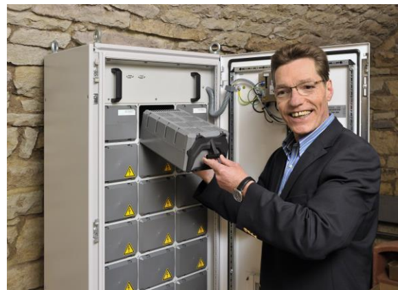
Lithium-Ionen-Batterie als Energiespeicher
